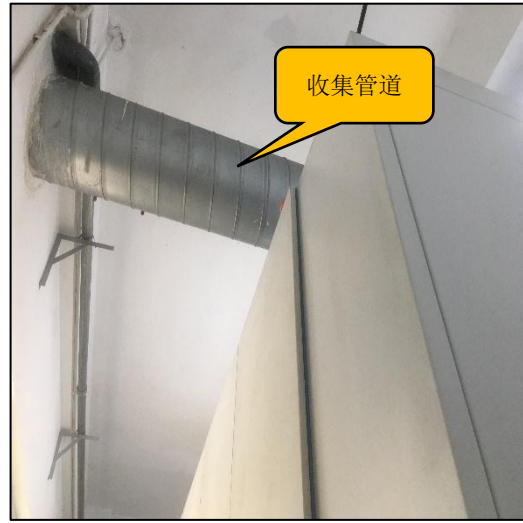
车间废气收集管道
