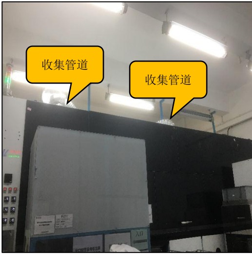
车间集气罩及收集管道
