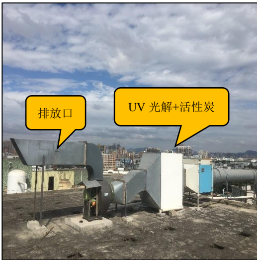
项目碳氢清洗废气设施及排放口
